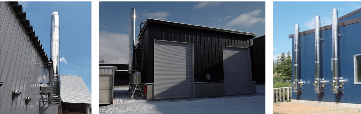
図表4-4 断熱煙突の例
