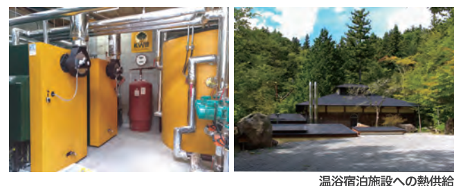
温浴宿泊施設への熱供給
