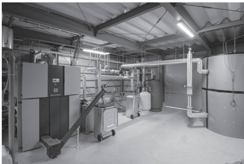
はぎ乃湯に導入したバイオマスボイラー（筆者撮影）
